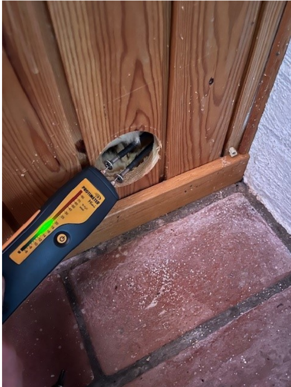
Fuktmätning i utreglad vägg i gillestugan.
