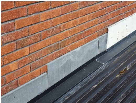
Ståndplåt glipar mot fasad.
