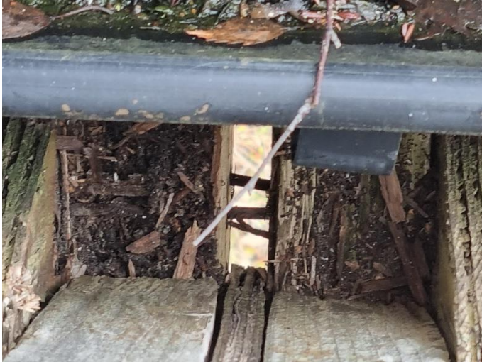
Röta vid sarginfästning runt garaget.
