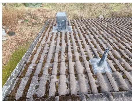
Mossa på taket. Plåtarbeten med målningsbehov.
