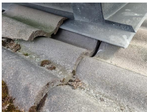
Glipa i läggningen.
