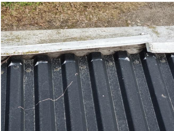
Vattplåt på garaget står upp och inblåsningsskydd saknas.
