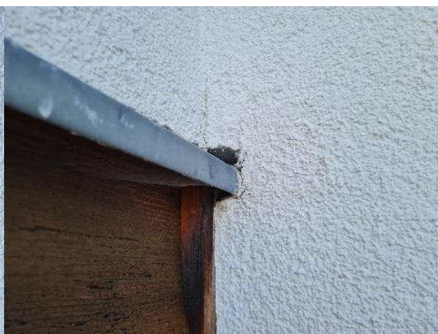
Bild 4 Exempel på lokal sprickbildning vid materialövergång
