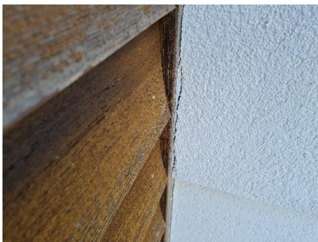
Bild 3 Exempel på lokal sprickbildning vid materialövergång
