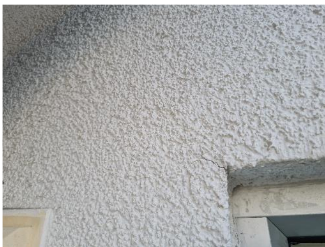
Bild 1 Exempel av lokal sprickbildning på hörn vid övre delen av fönsterpartier
