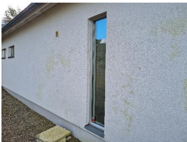
Bild 7 Exempel på lokal mikrobiell påväxt på fasaden
