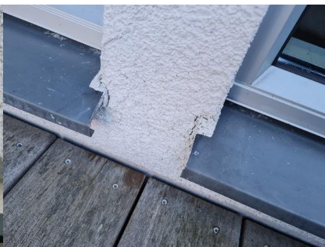
Bild 2 Exempel på lokal sprickbildning vid underbläck till fönsterparti
