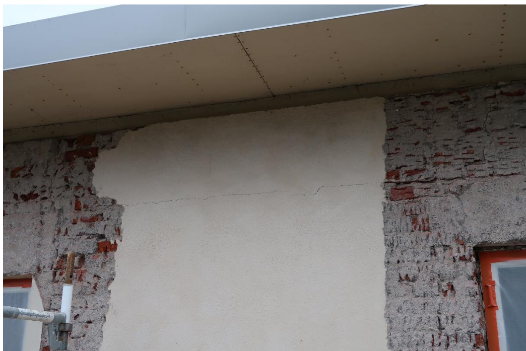
Horisontell spricka ovanför fönstren på södra fasaden.
