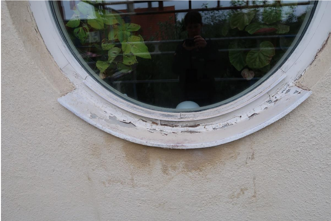
Vatten hade runnit in under fönsterblecket och skadat putsen under fönstret. Östra fasaden.
