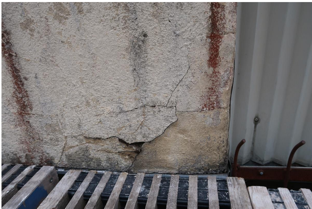
Sprucken puts på balkongen på grund av att underliggande järn har rost.
