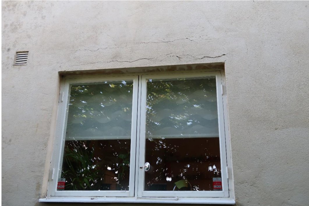
Spricka ovanför köksfönstret på västra fasaden.
