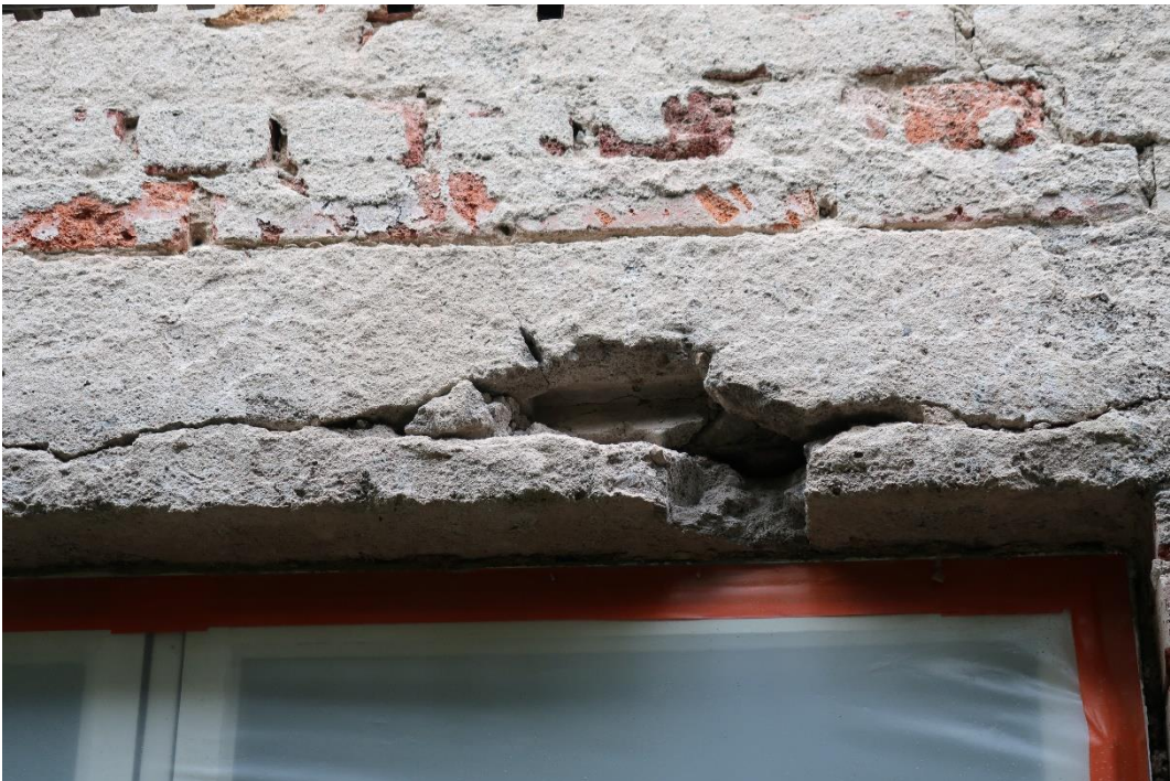
Sprickan ovanför köksfönstret efter att putsen tagits bort och sprickan delvis huggits upp.
