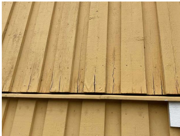
Bild 2: Utvändigt, Fasad, Färgsläpp och rötskadad panel noteras
