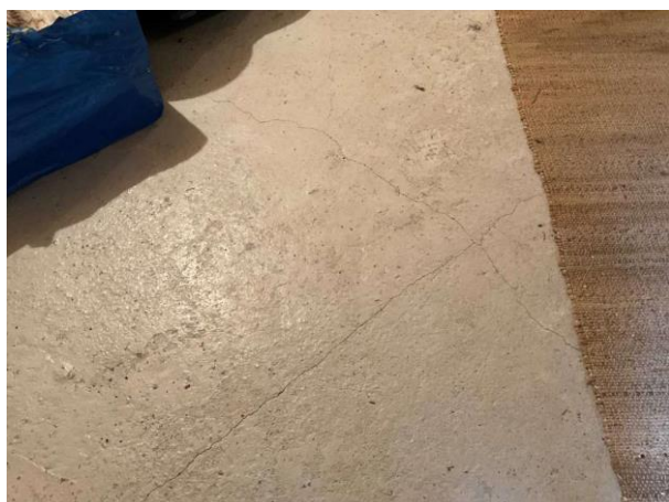
Bild 7: Invändigt, Källarplan Sprickor noteras på golvet
