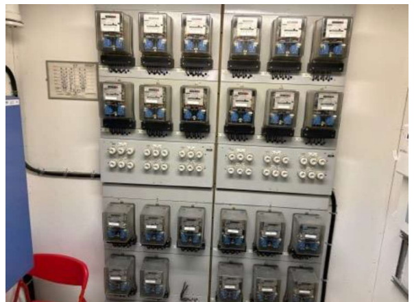
Lgh-mätare i elcentral källare
