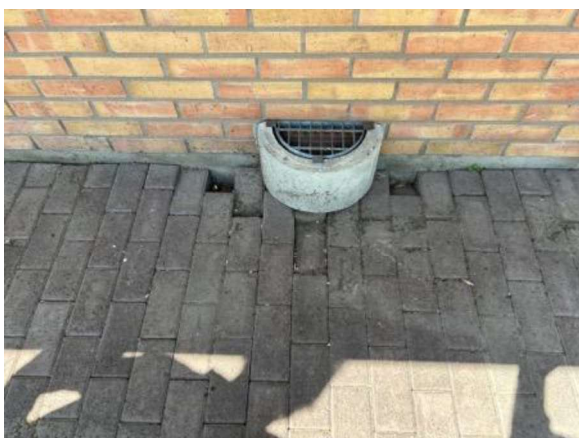
Sättningar i marksten kring ventilation källaren
