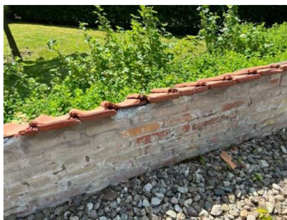
Skador på äldre mur mot grannfastighet
