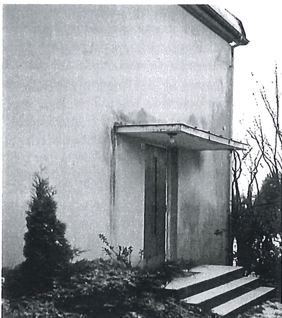
Entrésidan med putslagningar gjorda efter fuktskadan.
