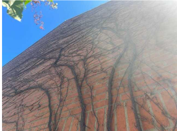
Bild 2: Utvändigt, Fasad, Rikligt med gamla klängväxter noteras på fasaden. Rötterna är klippta; rekommenderar att resterna avlägsnas.
