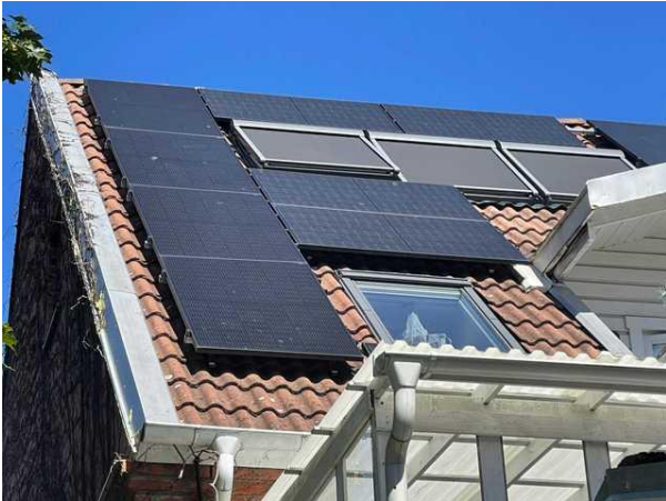
Bild 1: Utvändigt, Allmänt, Underhållet av plåtkonstruktioner/detaljer är eftersatt och rikligt med färgavflagningar noteras. Plåten under är galvaniserad och risken fö...
