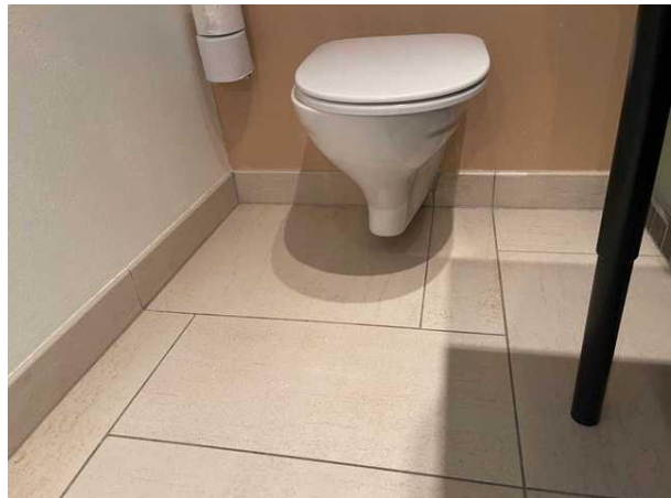
Bild 4: Invändigt, Entréplan, Badrum, Dräneringshål för läckageindikation saknas för toalettstolens inbyggda vattencistern. Se riskanalys 3.1.
