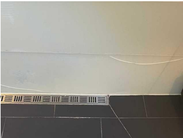
Bild 3: Invändigt, Plan 3, Tvätt/badrum, Ytsprickor noteras på kakelplattor. Har ej förändrats sen säljaren förvärvade fastigheten. Vid kontroll med fuktindikator indikerades inga f...
