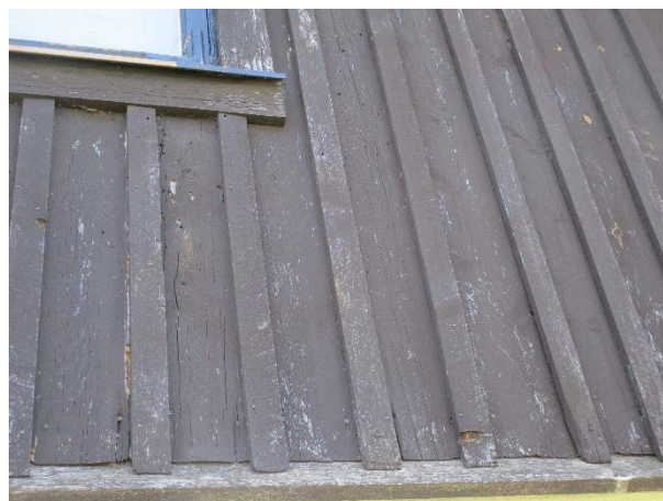
Fasadens träpanel är i behov av underhåll
