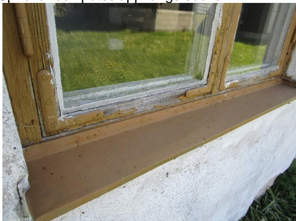
Fönstren är i behov av underhåll
