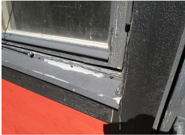
Fönstren är i behov av underhåll
