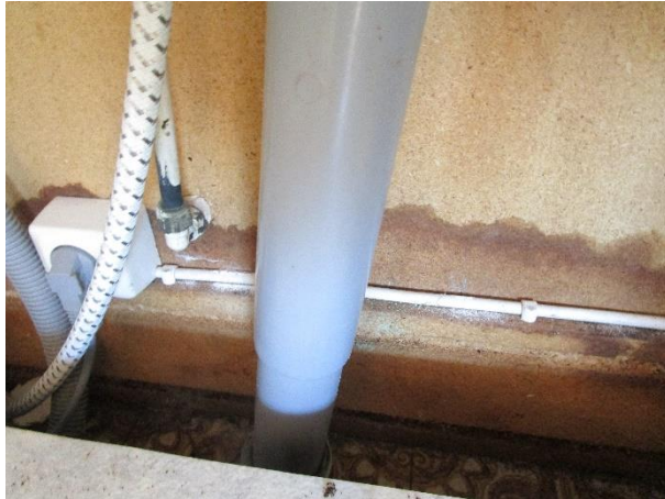
Fuktrosor längs vägg under diskbänk
