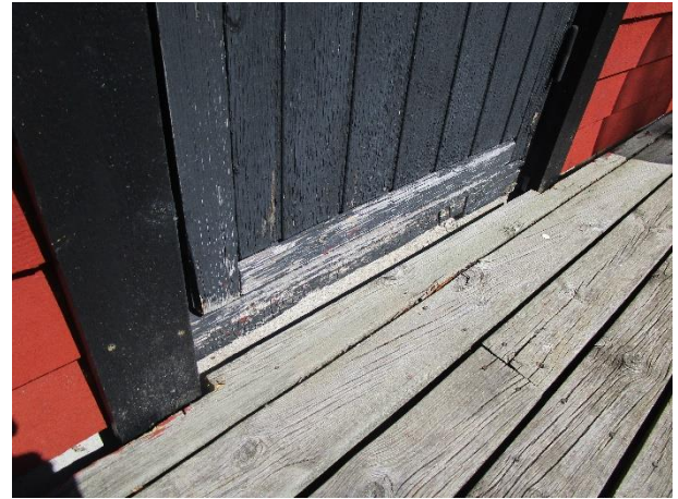
Dörrarna är i behov av underhåll
