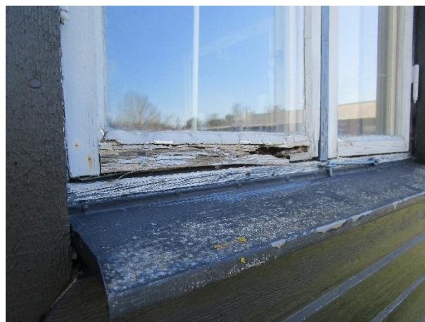
De äldre fönstren har ett underhållsbehov
