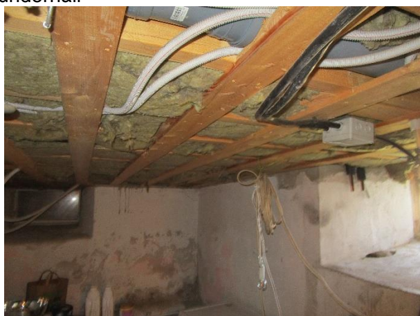
Tvättstugan inte färdigställd efter renovering
