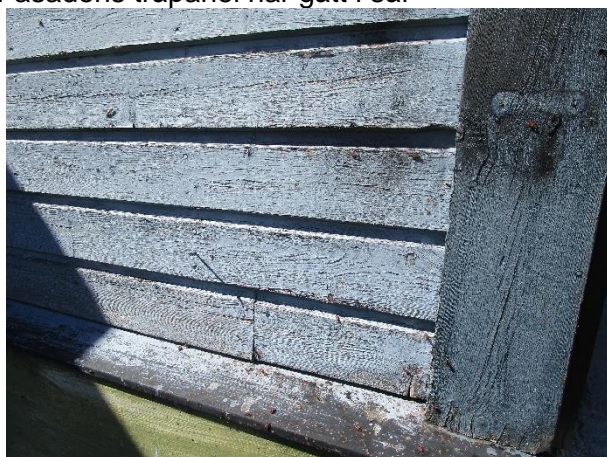
Fasadens panel mot norr är i behov av underhåll
