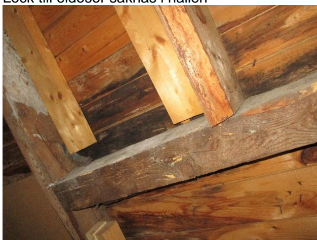
Fuktgenomträngningar längs yttertaketets insida
