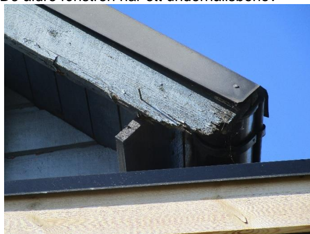
Rötskador på vindskiva mot norr
