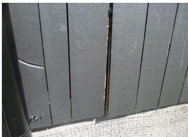
Fasadens träpanel har gått i sär
