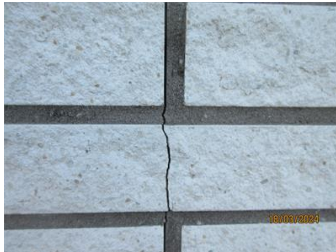
Spricka i tegelfasad.
