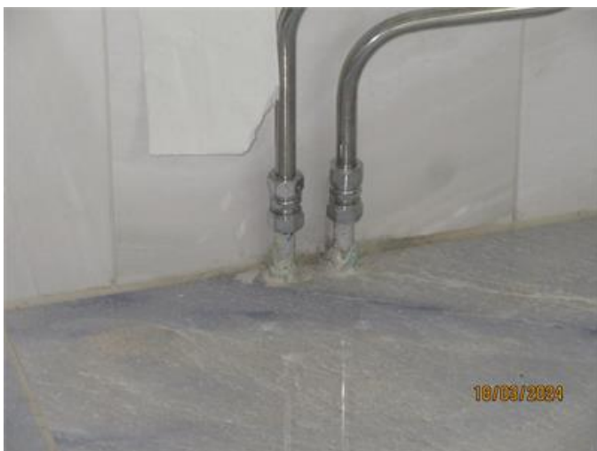
Rör genomföringar i vårumsgolv.
