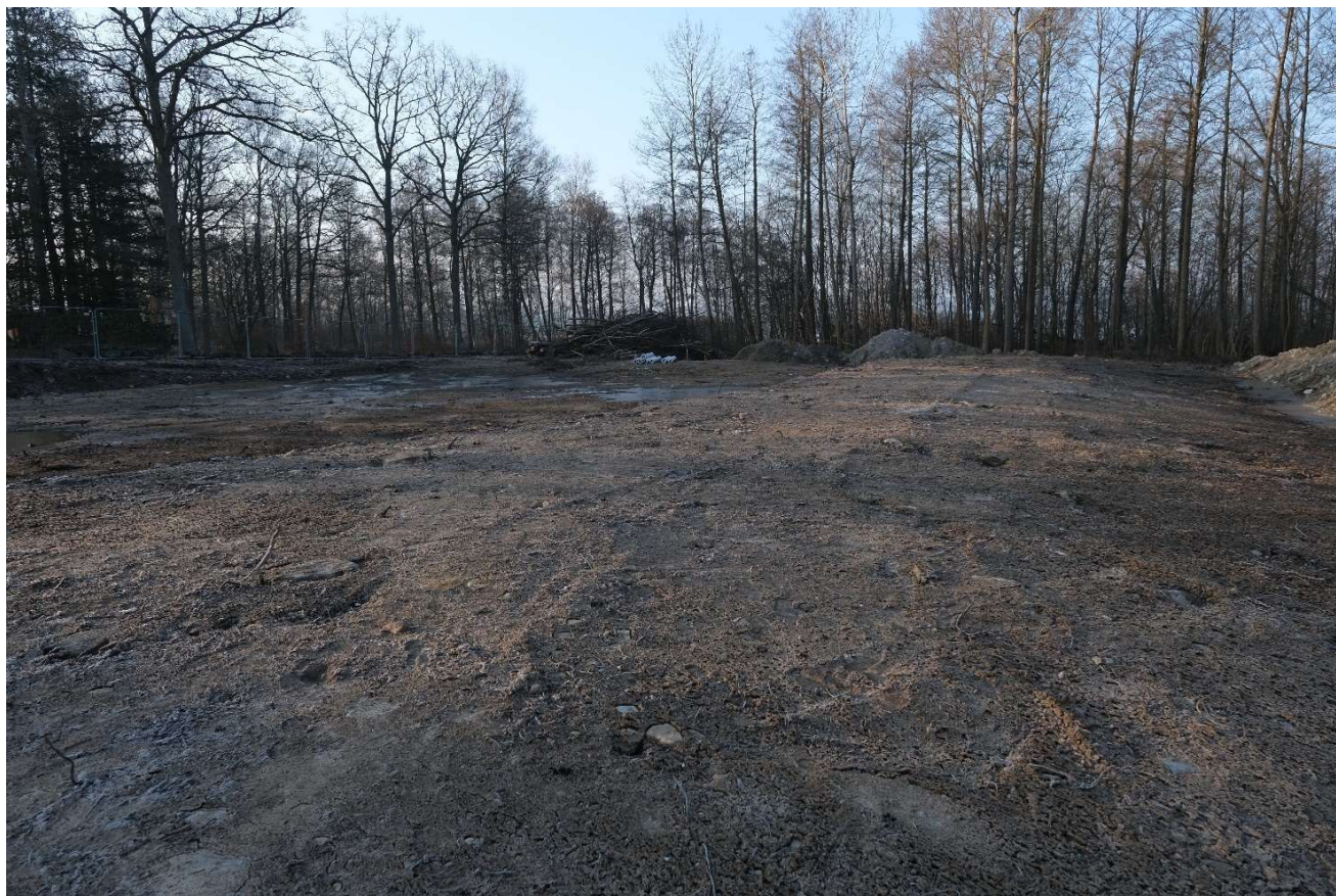
Figur 15 Slät packad yta som underlag för markduk, ev. rötter o stenar som kan skada duken avlägsnades.
