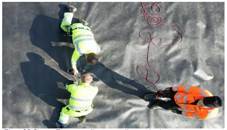
Figur 20 Svets. En styr mellanrum enligt markering, en styr svets en tredje håller koll på kablage.
