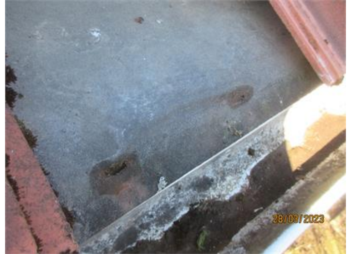
Skador finns på underlagspapp.
