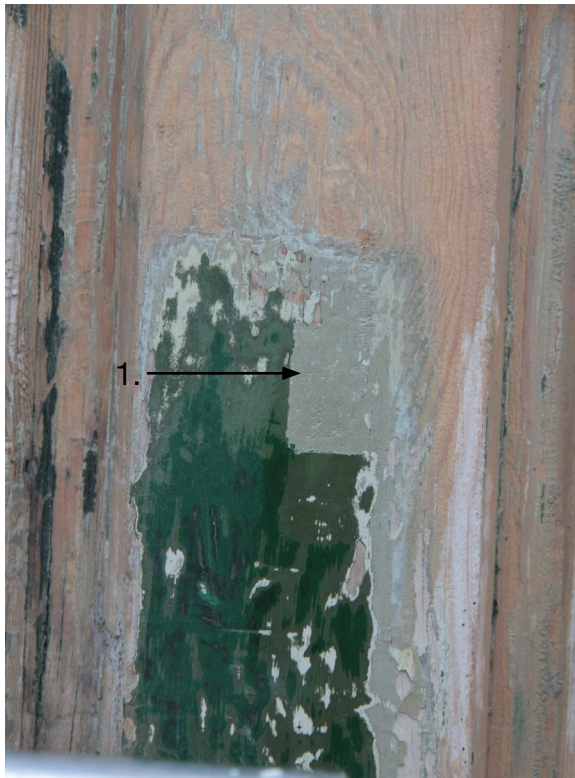
Framskrapad originalkulör på en garagedörr åt Vilstavarvsvägen.
